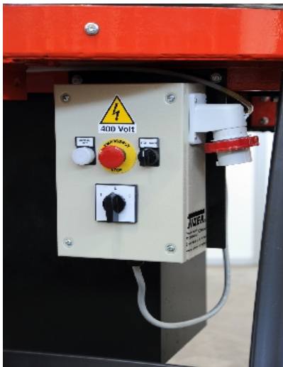
Quadro elettrico su cassetta metallica
